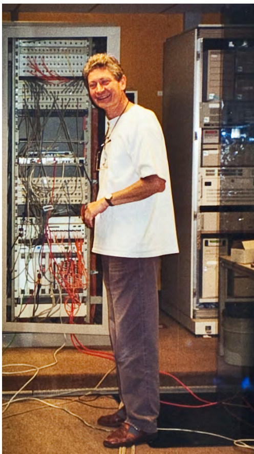
Aufbau der IT- und Netzinfrastruktur
